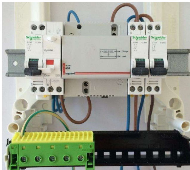
Afbeelding 9: gemonteerde Legrand-filter in een enkel fase groepenkast/meterkast
